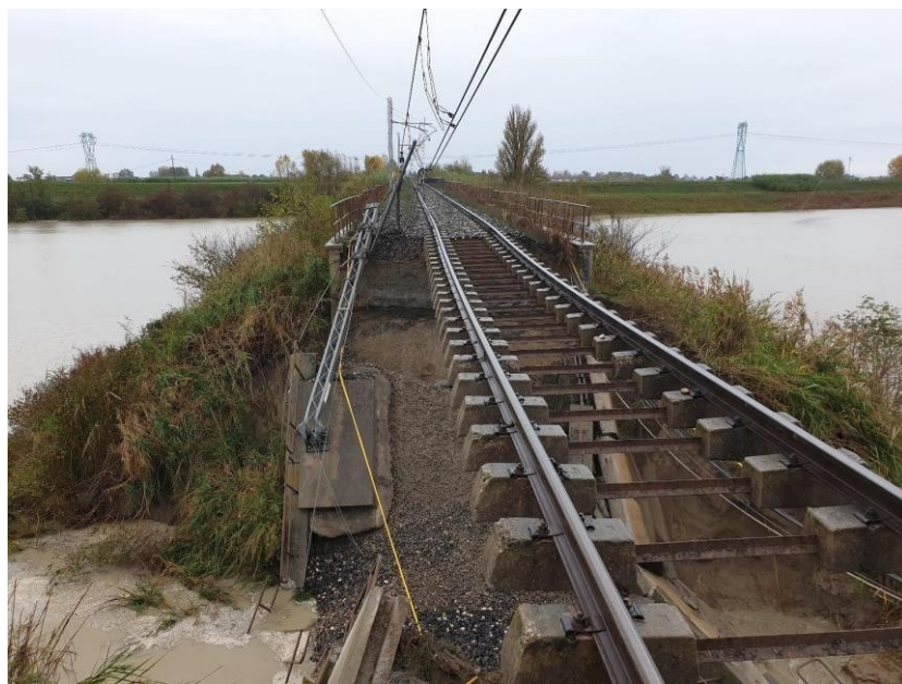
Dissesto strutture di attraversamento
