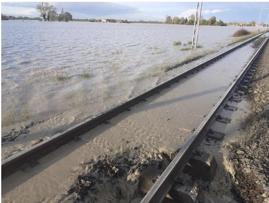
Allagamento con deposito di limo sul rilevato
