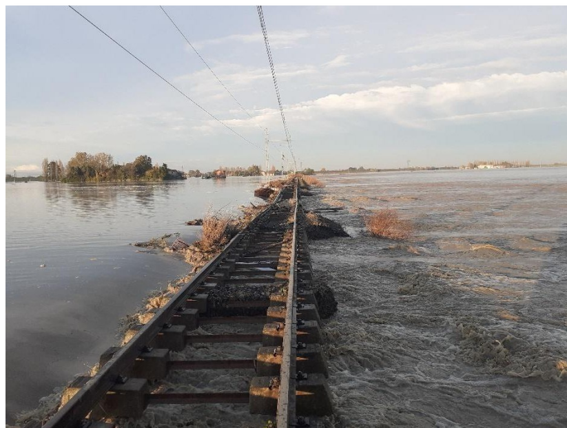
Deflusso trasversale con erosione del rilevato
