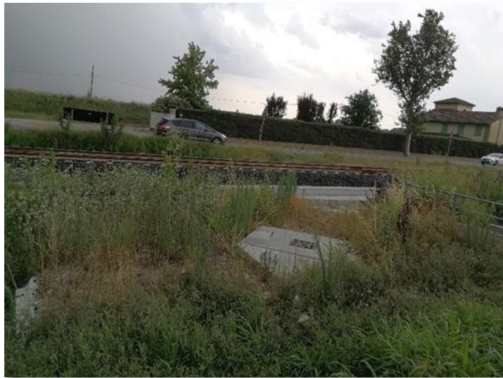
Sistema di drenaggio della linea ripristinata
